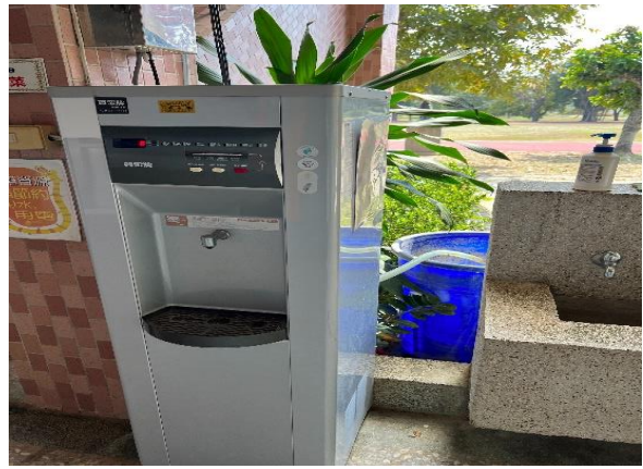
校園貯水設備 2
